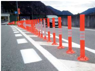
岐阜県 国道41号 逆走防止
