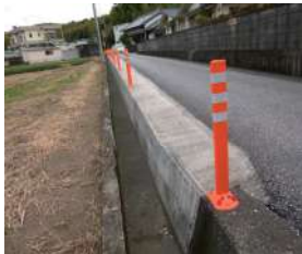
高知県高知市 転落防止（用水路）
